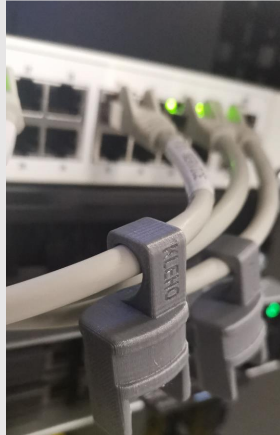
Cascos instalados en cable para uso eventual.
